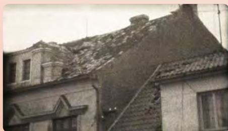
Lidák - Lidový dům - poškozená střecha a dům č. 58
